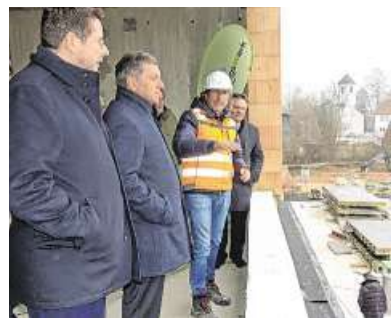
Stephan Stracke (links) und Minister Christian Bernreiter (Mitte) auf der Baustelle des Generationencampus Kleeblatt. Foto: Wolfgang Becker
