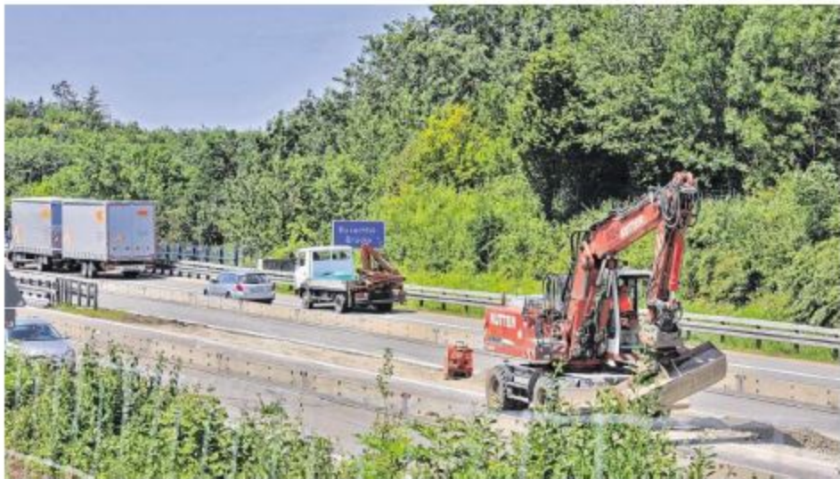
Für den Umbau westlich des Memminger Autobahnkreuzes haben die Vorarbeiten begonnen. Auf der Buxachtalbrücke ist die Sanierung der Fahrbahnbedeckung bereits abgeschlossen.
