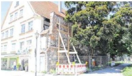
An der Kohlschanze ist ein Teil der Stadtmauer abgesichert, damit er nicht einstürzt.
