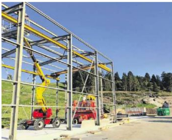
Die verantwortliche Tunnelbaufirma baut derzeit eine Werkstatthalte. Im Hintergrund der Bereich des künftigen Tunnelportals bei Bertoldshofen. Foto: Dirk Ambrosch
